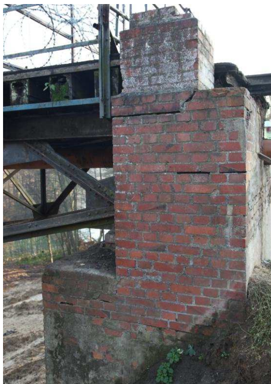
Rys. 14. Widok stanu technicznego filara zachodniego.
