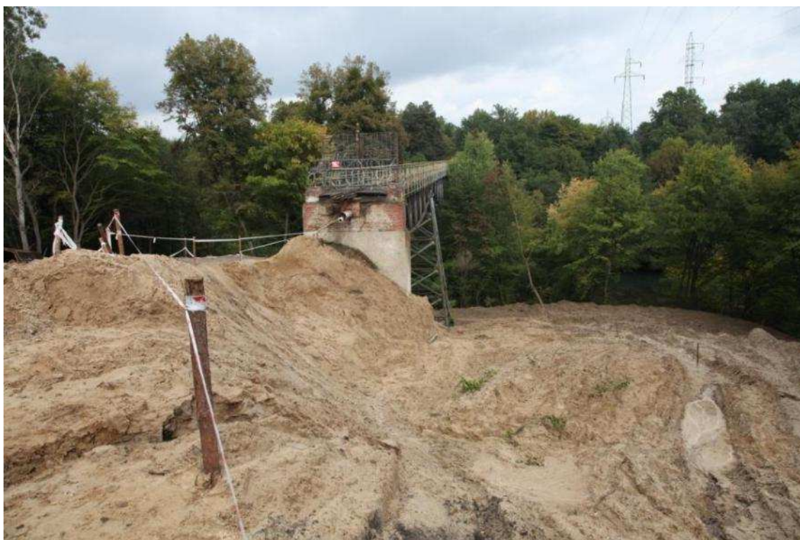
Rys.2. Stan osuwiska, widok od strony zachodniej, listopada 2013.
