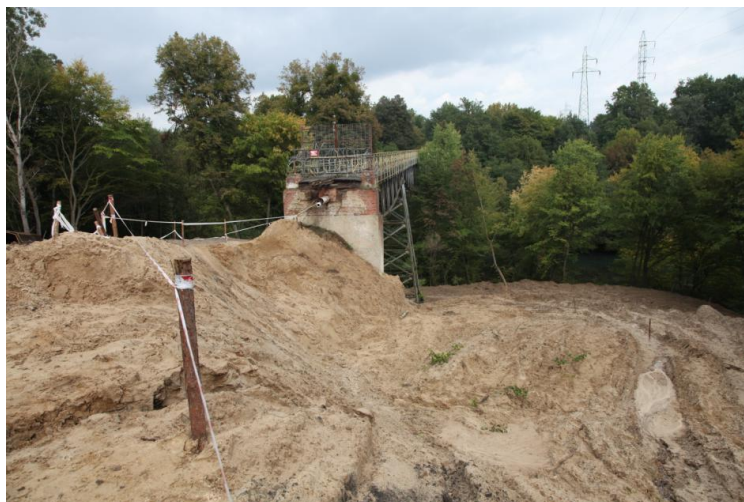
Rys.2. Stan osuwiska, widok od strony zachodniej, listopada 2013.
