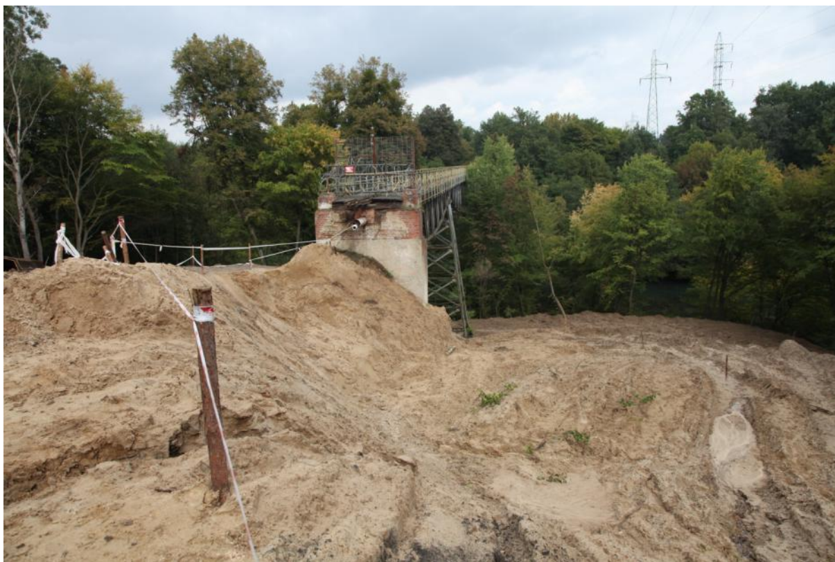
Rys.2. Stan osuwiska, widok od strony zachodniej, listopada 2013.
