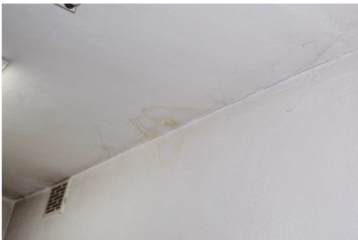
Fot. nr 6 ściana wschodnia – widoczne ślady zalania wodą
